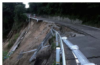
▲崩落したごまじり地区に向かう道
